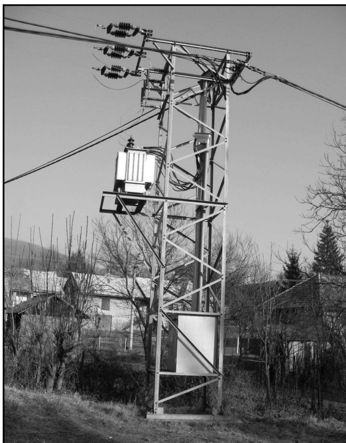
Najnovší (tretí) transformátor v obci
