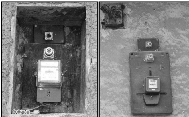
Ukážky nevhodných elektromerových rozvádzačov
